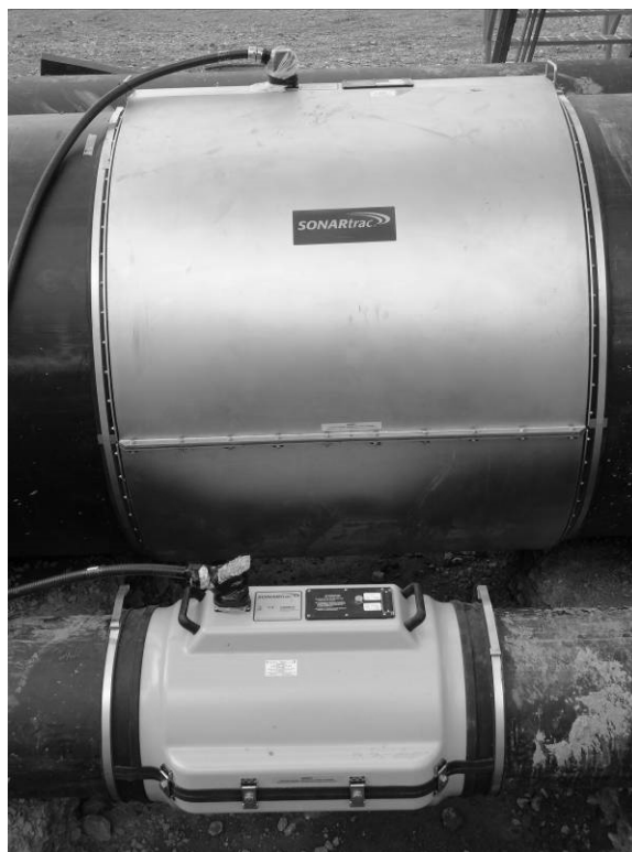
Figura 7 Cabezales del sensor de 54 in y 16 in instalados
