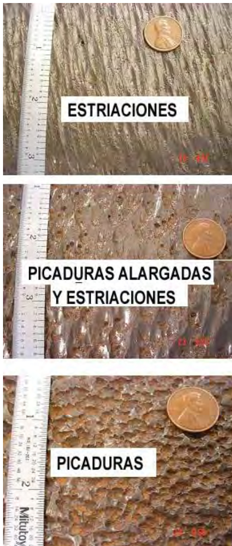
Figura 21: Irregularidades de superficie interior observada en una cañería de cromo-acero con desgaste
