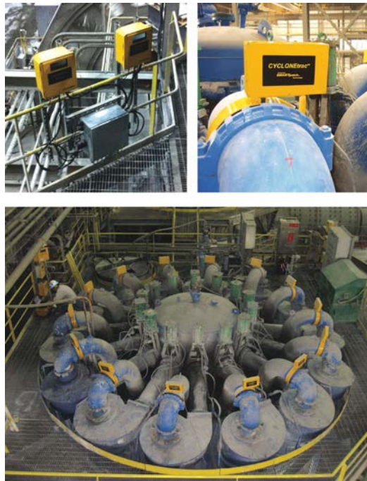
Figura 1 Sistema CYCLONetrac OSM instalado en Kennecott con transmisor y caja de conexión (foto superior izquierda) y una batería de hidrociclones completamente instrumentada (foto inferior)
