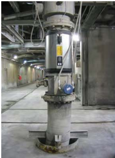
Figura 3: Medidor de flujo y aire arrastrado Sonar pasivo
