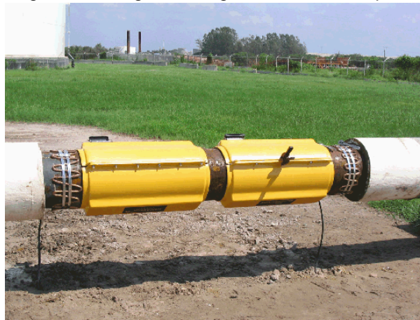
Cabezas de Sensores Sin Aislación y Bandas de Conexión a Tierra Instaladas
