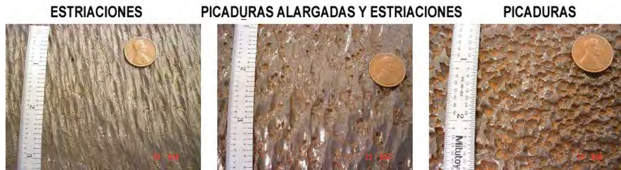
Figura 19: Irregularidades de superficie interior observada en una cañería de cromo-acero con desgaste
