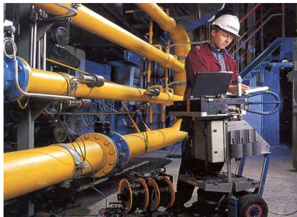
Figura 5 Calibración en terreno de una línea de flujo de gas natural
